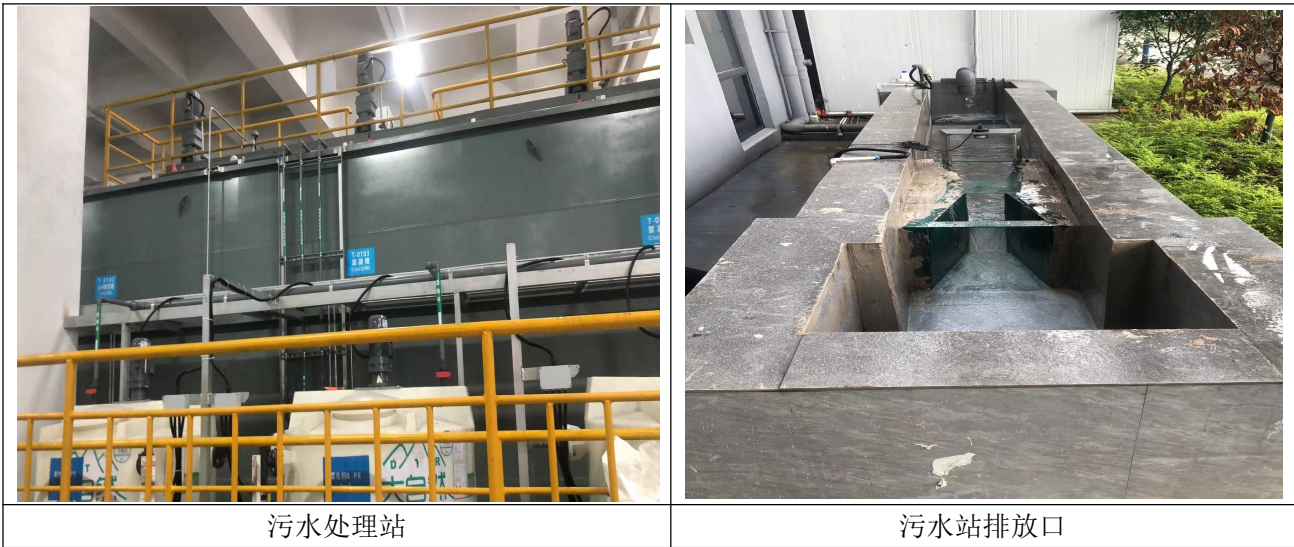
图 5-3 项目废水处理设施现场情况
